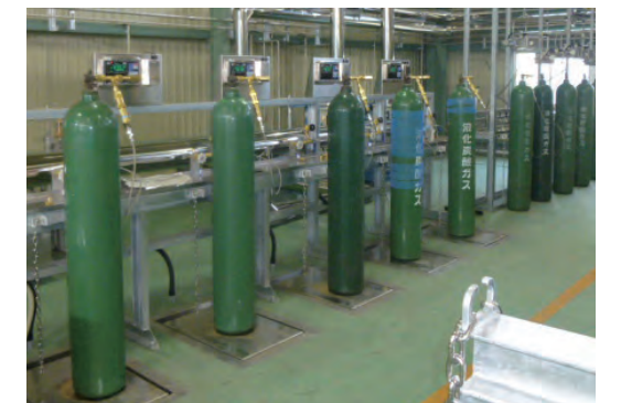
ガス再生・充填施設
